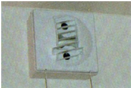
← Abluftventil mit Zugschnurschalter und Brandschutzautomat
