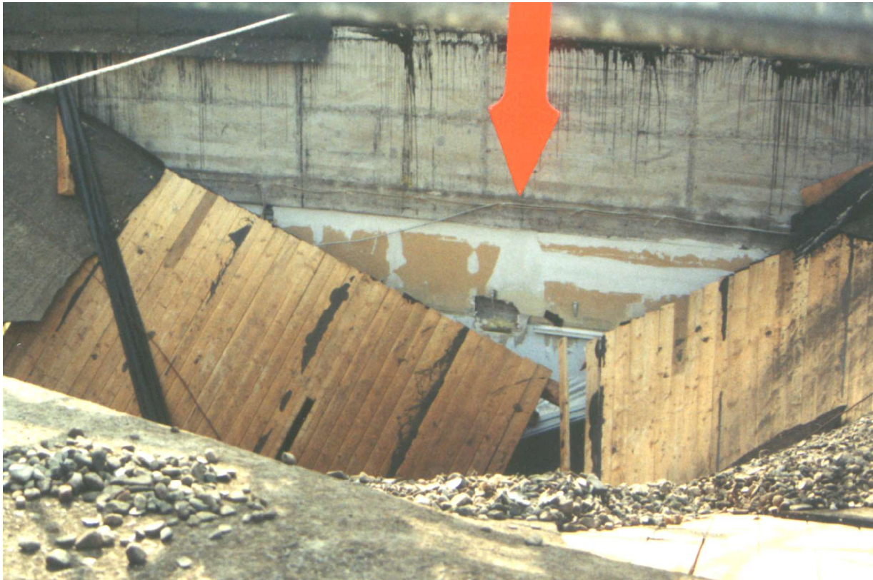
Bild: Teileinsturz eines Flachdaches bei Sanierungsarbeiten durch Einzellastüberschreitung. (Foto entnommen aus einer Versicherungsakte)
