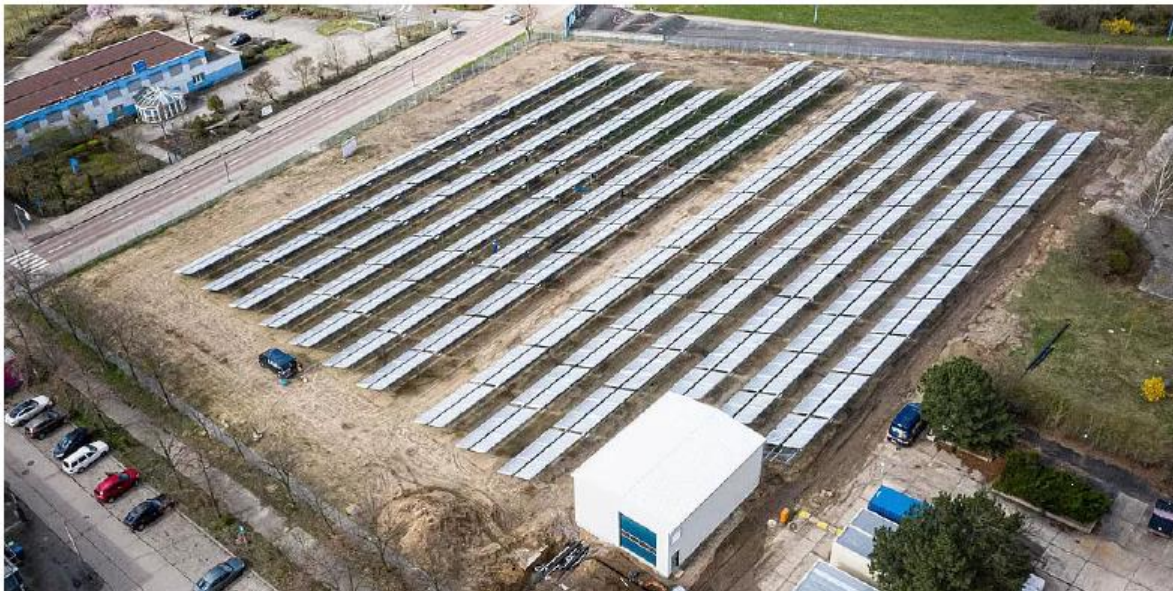
So sieht die Solarthermie-Anlage in der Draufsicht aus.
